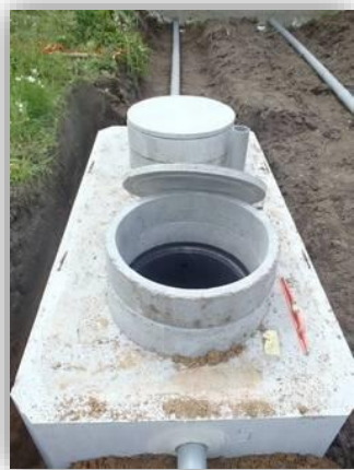
Fosse toutes eaux
