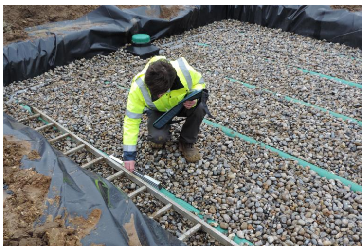
Contrôle d'un filtre à sable drainé
