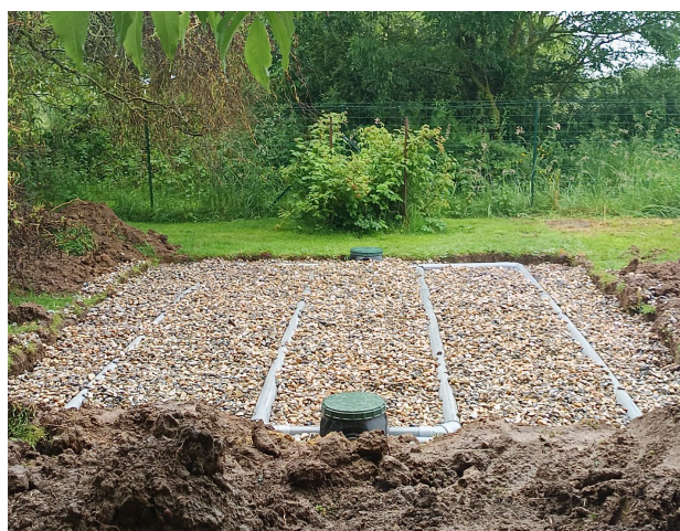
Assainissement non collectif composé d'un lit d'épandage
