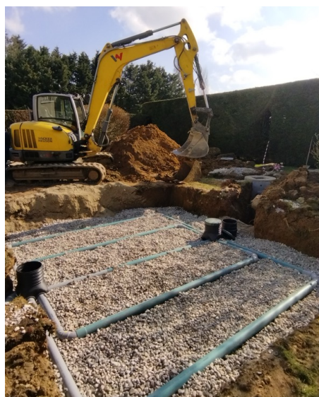
Assainissement non collectif composé d'un lit d'épandage
